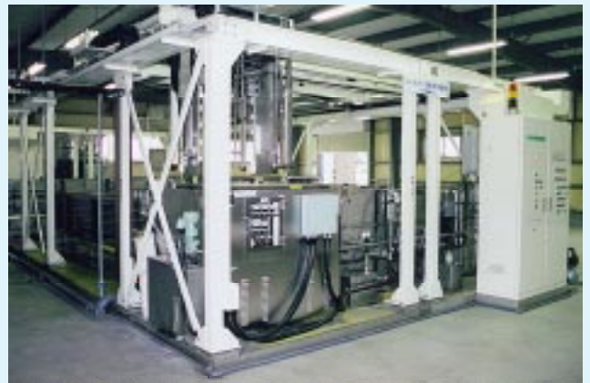
超音波フィルタ自動洗浄設備
