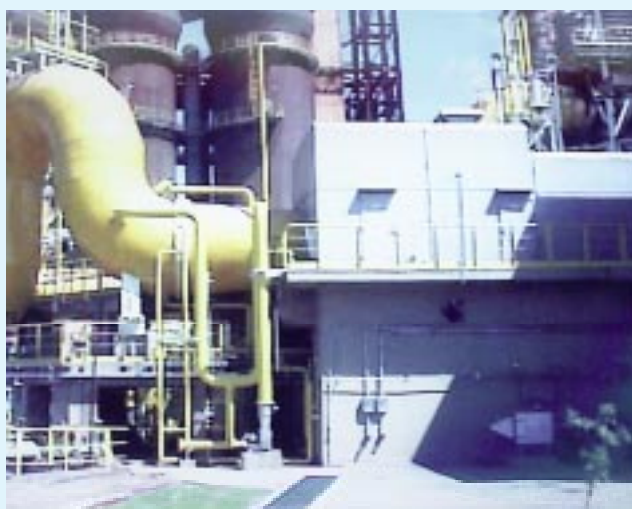
炉頂圧回収発電タービン設備[ ブラジル ]
