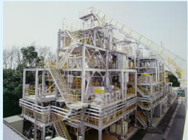
高効率熱回収ごみ焼却設備 [流動床ガス化溶融炉・実証試験設備]
