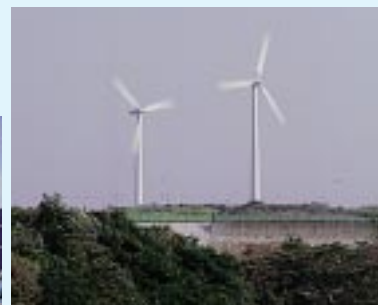
風力発電設備
