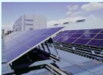
太陽光発電設備
