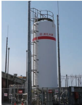
図5 解析対象とした液化水素タンク (JAXA) Fig. 5 Liquefied hydrogen storage tank (JAXA)
