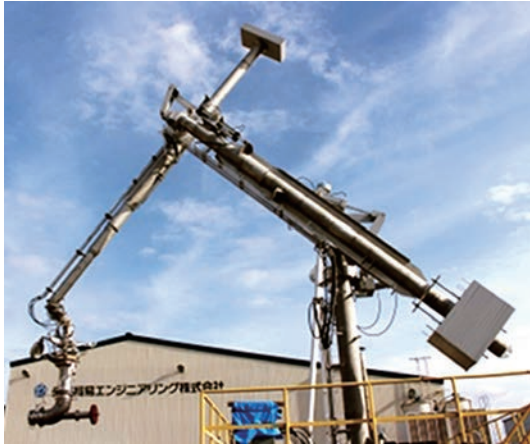
図8 商用液化水素ローディングアームシステム Fig. 8 Liquefied hydrogen loading arm systems for commercial use
