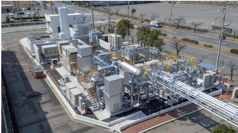
図5 水素ガスタービンコージェネレーション実証設備（神戸市）
