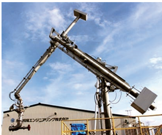
図8 商用液化水素ローディングアームシステム Fig. 8 Liquefied hydrogen loading arm systems for commercial use
