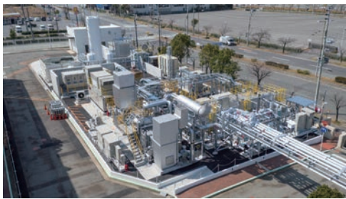
(a) 設備外観
