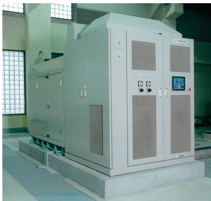
高効率かつメンテナンスフリーを実現する磁気軸受を採用した曝気用ブロワ
