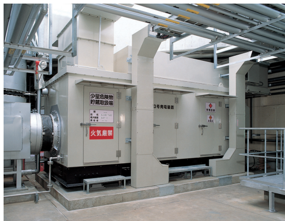
図6 デュアルフューエル仕様のガスタービン Fig.6 Gas turbine of dual-fuel specification
