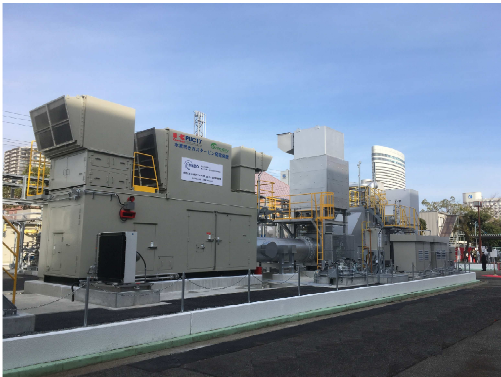
ドライ低NOx水素専焼ガスタービンの実証試験プラント
