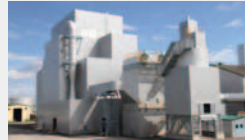
ホクレン農業協同組合連合会向けボイラー発電所設備
