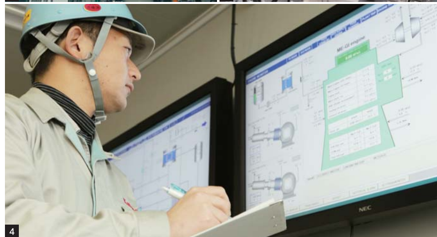
極低温タンクで低温に保持されたLNGがパイプを通ると、あっという間に霜が出る(写真1、2)。次に高圧ポンプ(写真3)で昇圧されていく。システムの状態は制御室で集中監視され、データの収集が続いている(写真4)
