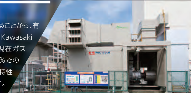
水素混焼技術：当社工場内でガスタービン実証運転中 (水素専焼技術：実証運転を計画中)
