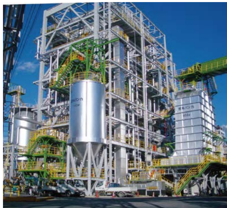
蒸発量: 75t/h 蒸気圧力: 9.81MPaG 温度: 501℃ 使用燃料: 廃木材・廃プラ・RPF(新東海製紙株式会社 島田工場殿向け)
