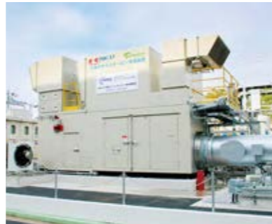
燃焼時にCO 2 を排出しない水素焚きガスタービン
