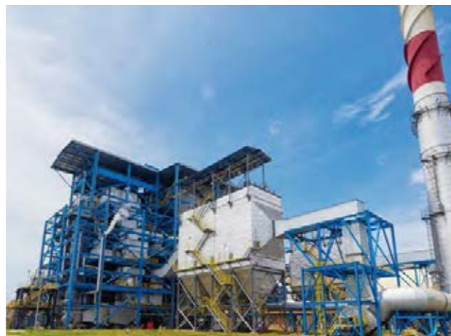
微粉炭焚ボイラへの間接燃焼方式導入例(インドネシア・SEMEN TONASA殿向け、144T/H×2缶)
