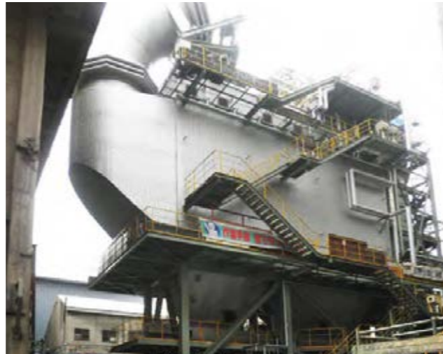
上磯工場排熱発電設備、出力: 19,100kW (6号プレヒーター用排熱ボイラ設備)
