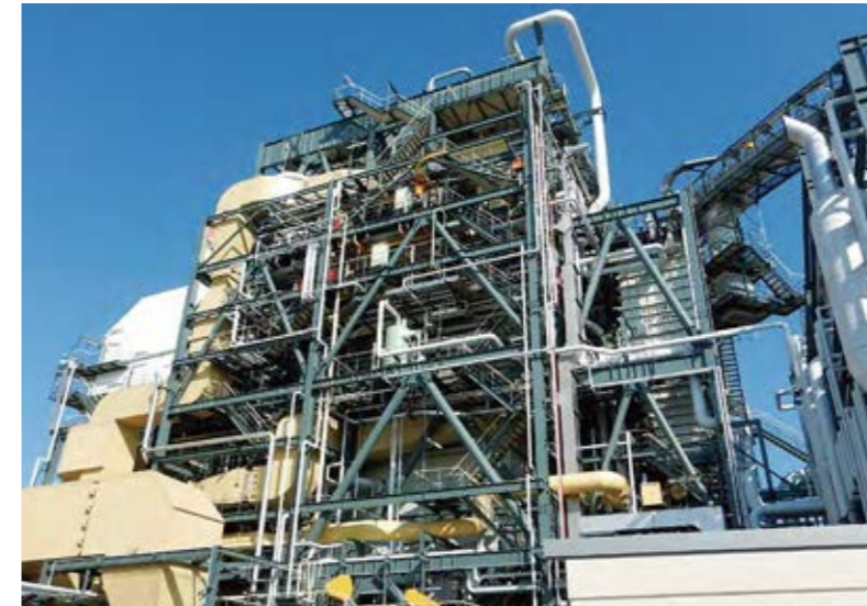
U-KACCボイラ適用プラント
