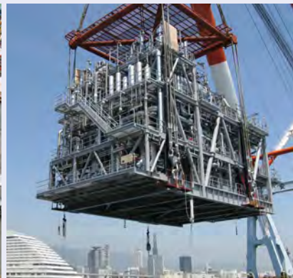
ガスコンプレッションモジュール
