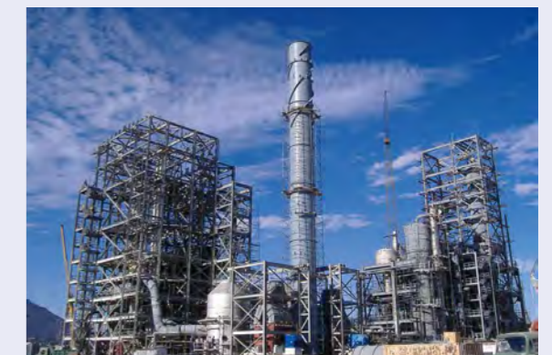
ケルマンシャ石油化学工業社尿素肥料プラント
