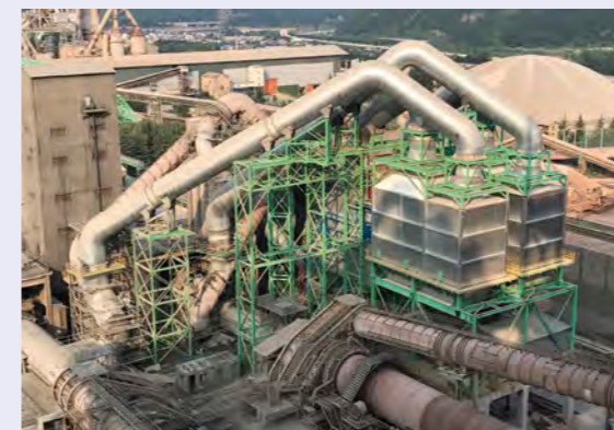
サンヨンセメント・東海工場向けセメント排熱発電設備
