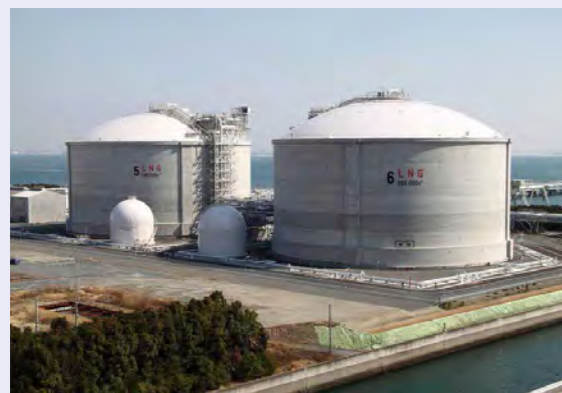
中部電力川越火力発電所向けLNGタンク
