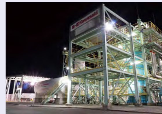
実証運転を行った水素液化機
