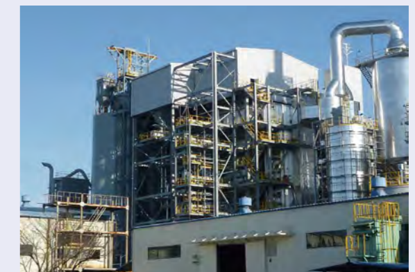
内部循環流動床ボイラの海外向け初号機(韓国)
