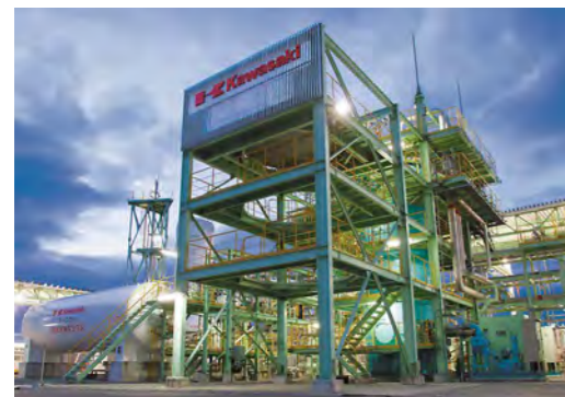
播磨工場内に建設された水素液化プラントの実証設備
