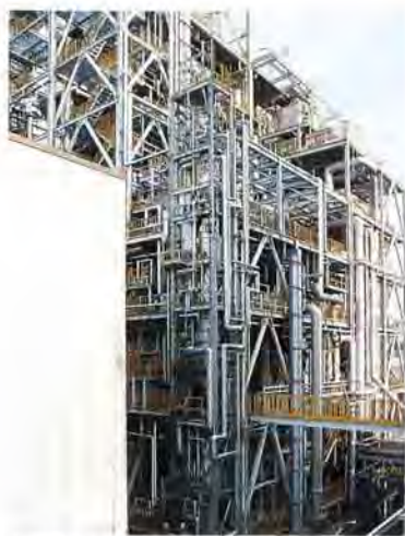
石炭ガス化複合発電用ガス精製装置
