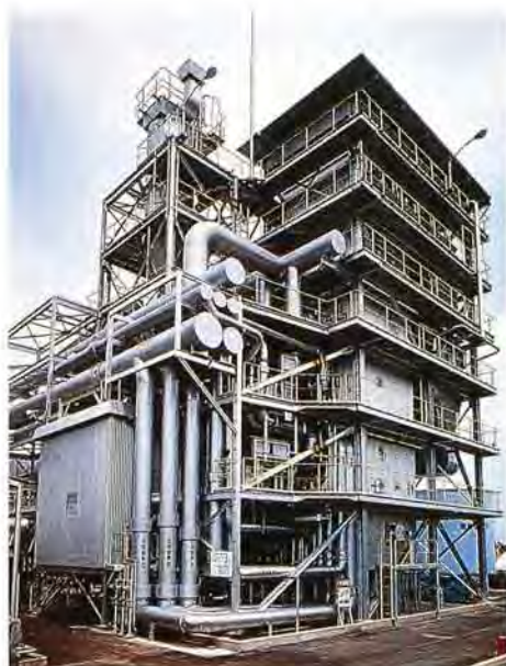
滋賀燃焼試験所に設置の流動床燃焼試験設備
