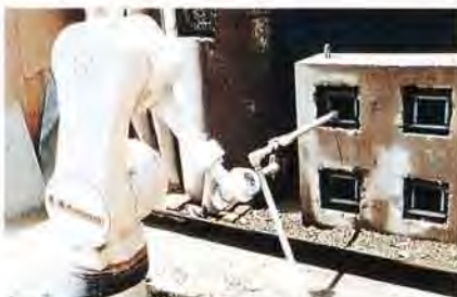
ウォータジェットによるコンクリート構造物のはつり・解体
