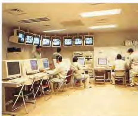
関西国際空港BHS/CRT操作室——1994年
