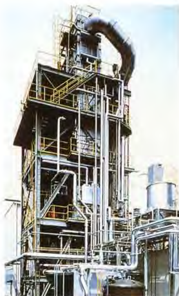
内部循環流動床式ごみ焼却実証炉
