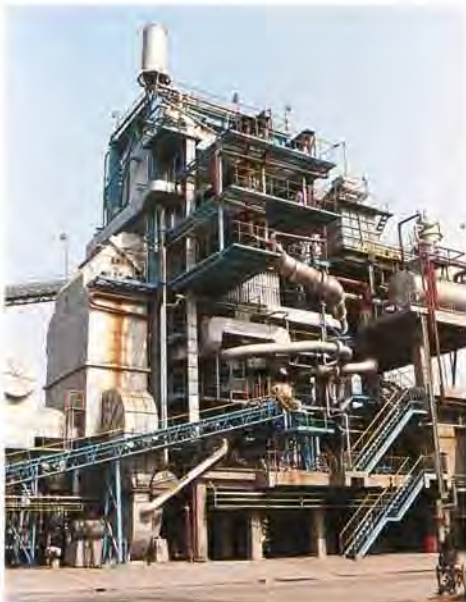
大王製紙・三島工場向けスラッジ燃焼ボイラ
