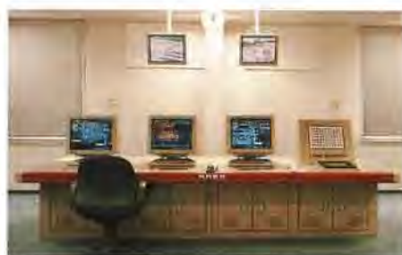
東北電力・原町発電所運炭システム制御室——1996年
