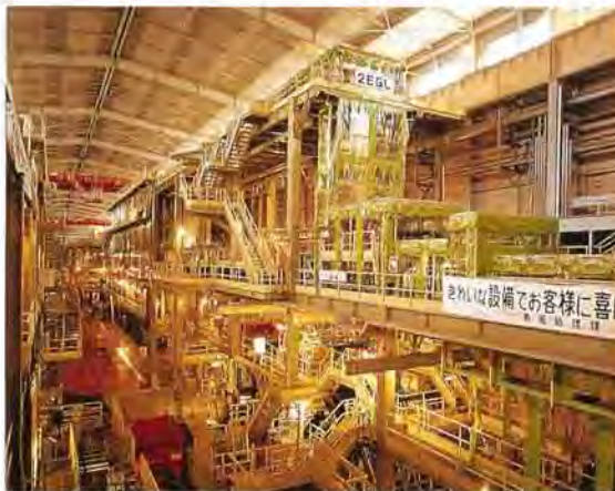
川崎製鉄・水島製鉄所向け電気亜鉛メッキ設備——1990年
