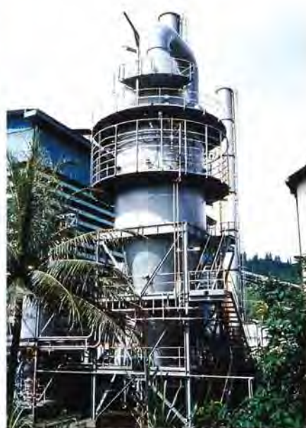
インドネシア向け半乾式簡易脱硫装置——1993年
