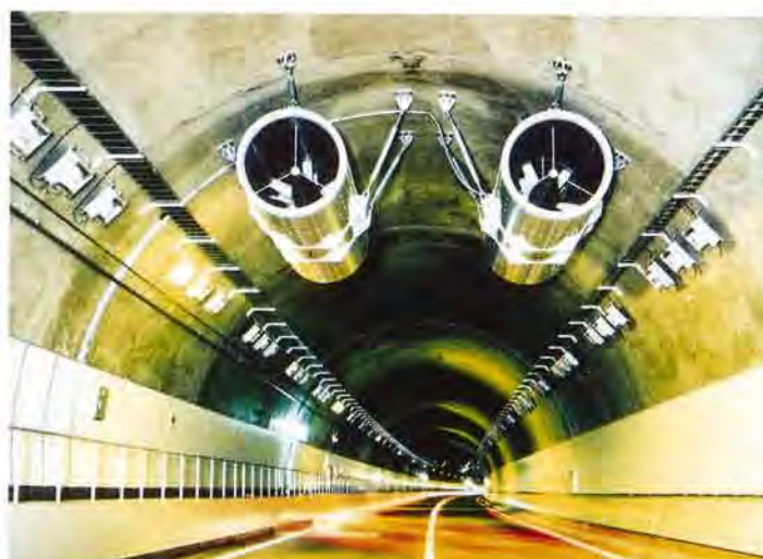
ジェットファン据付状態
