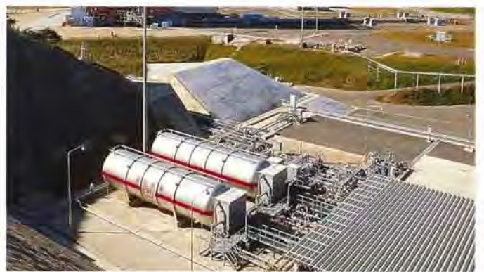
H-Iロケット射点液体水素設備
