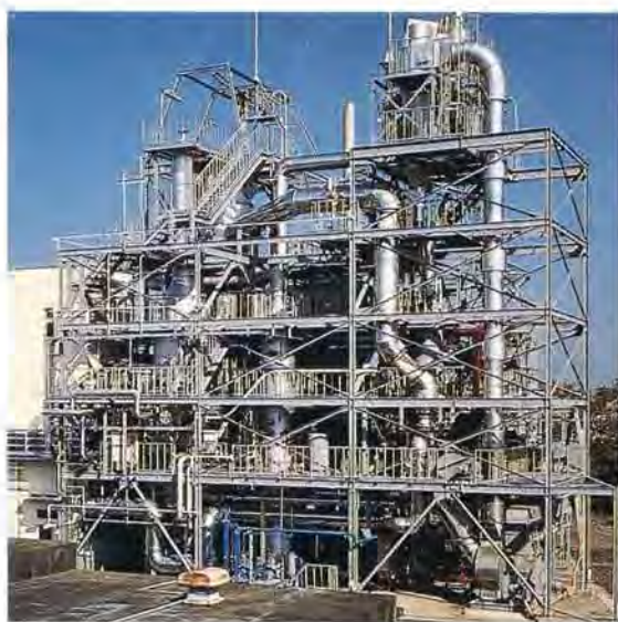
浜松市・下水汚泥焼却設備(KADDISシステム)
