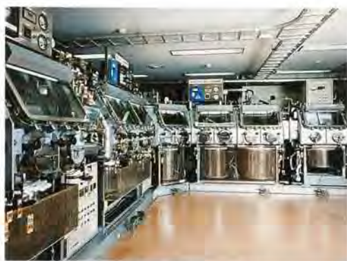
電力中央研究所向け群分離乾式プロセス試験設備
