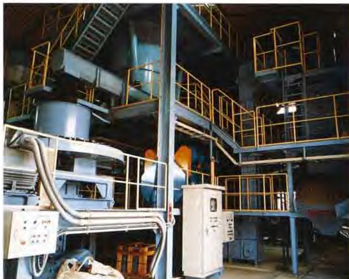
RDF実証プラント（八千代工場）
