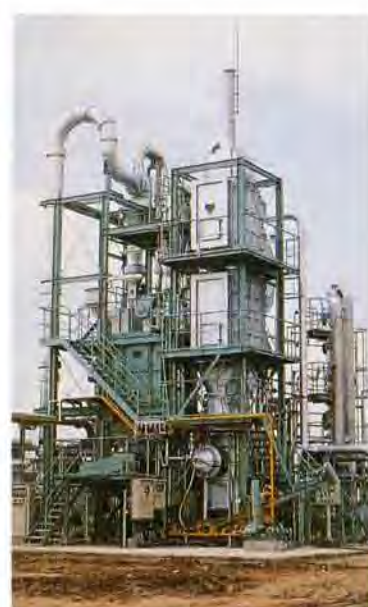
下水汚泥乾燥・焼却・熔融兼用設備
