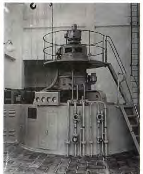
早川発電所発電機——1956年
