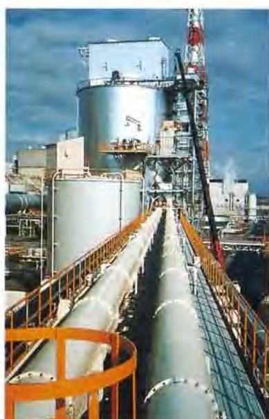
北海道電力・苫東厚真発電所向けFDC——1995年
