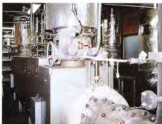
トンネル排気脱硝・脱硫装置
