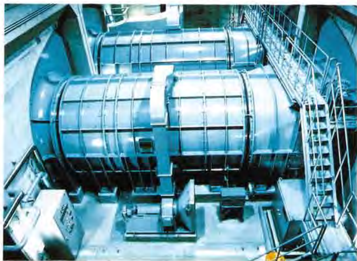
軸流送風機（第2新神戸トンネル）——1988年
