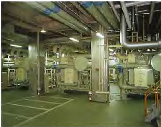
神戸ハーバーランド地域冷暖房プラント——1990年
