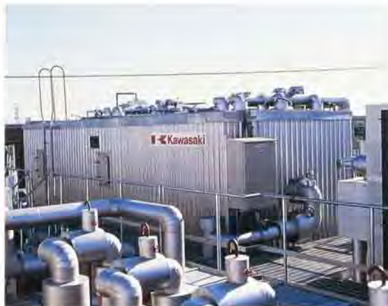
水蓄熱システム
