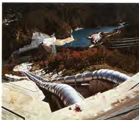
電源開発・奥清津発電所水圧鉄管——1977年
