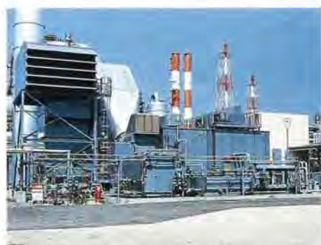
大阪石油化学向け25MWガスタービン発電設備——1988年
