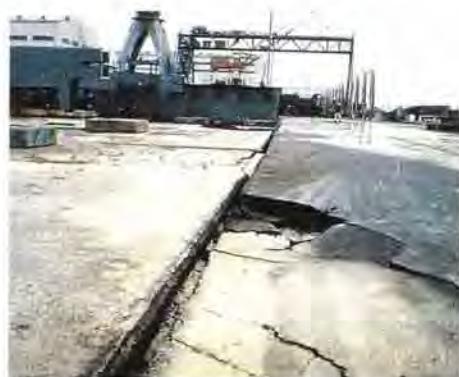
阪神淡路大震災被災時の播磨工場
