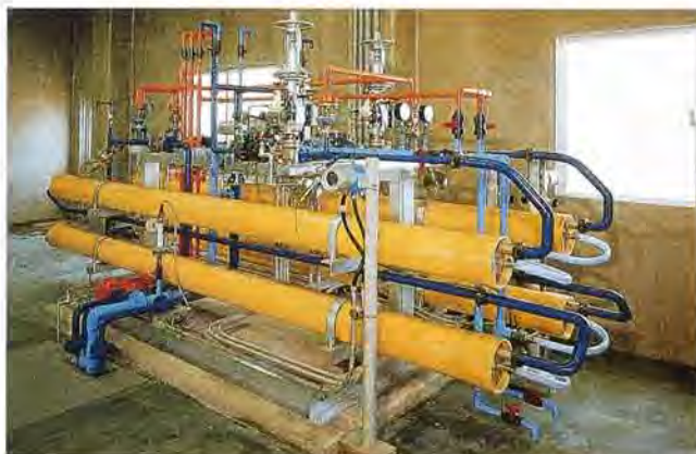
逆浸透 (RO) 膜造水設備
