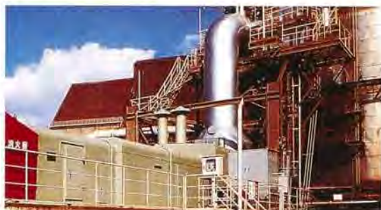
炉頂圧回収タービン——1974年
