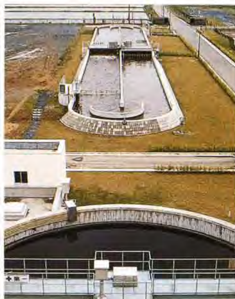
オキシデーショントイッチ (OD) 設備
