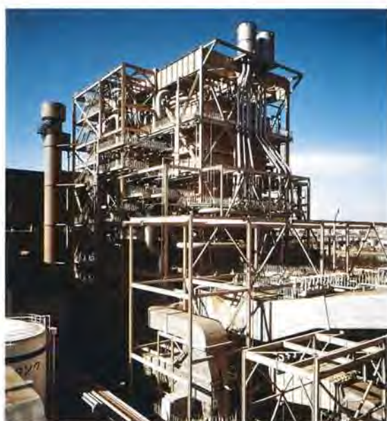
東京電力・大井発電所3号機
