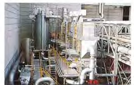
総合排煙処理実証試験装置(四国電力・西条発電所)
