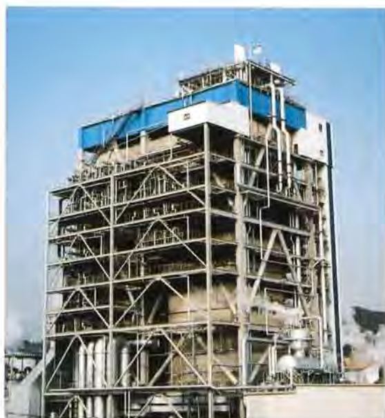
日本製紙・岩国工場向け回収ボイラ
