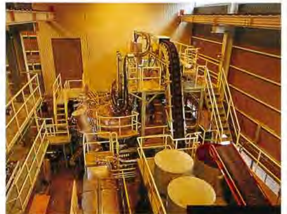
ごみ焼却灰プラズマ溶融装置
