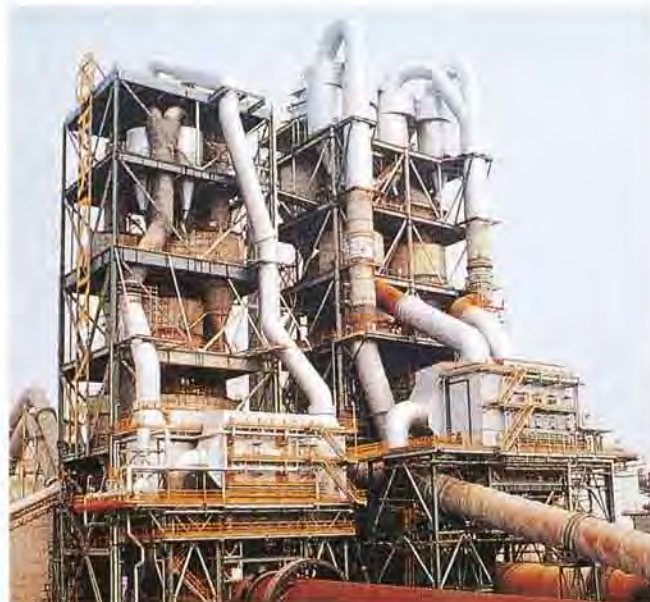
セメントプラント用廃熱ボイラ
