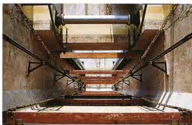
沈殿池機械設備
