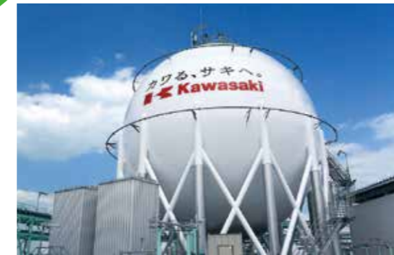
液化水素貯蔵タンク
